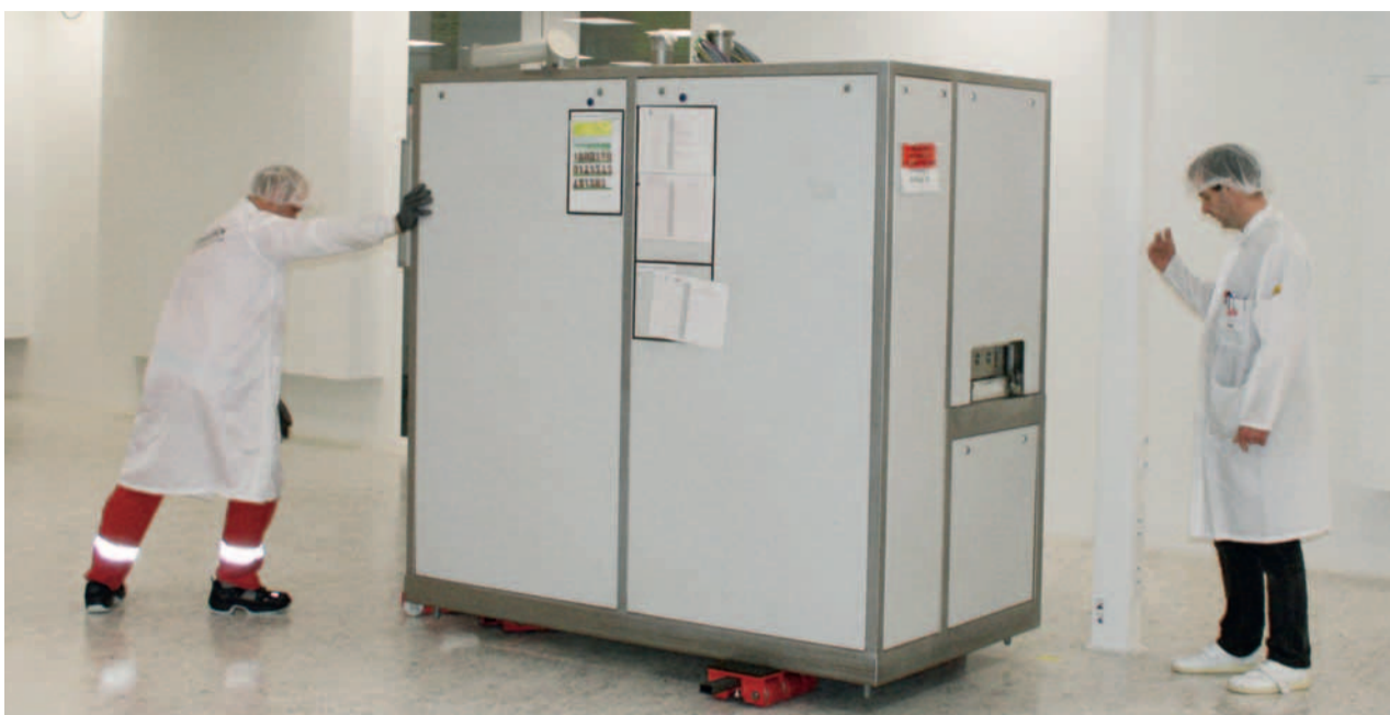
F.W.-Neukirch-Mitarbeiter bauen eine Chip-Produktionsanlage bei Danfoss in Flensburg auf. Zuerst wird sie positioniert ...
